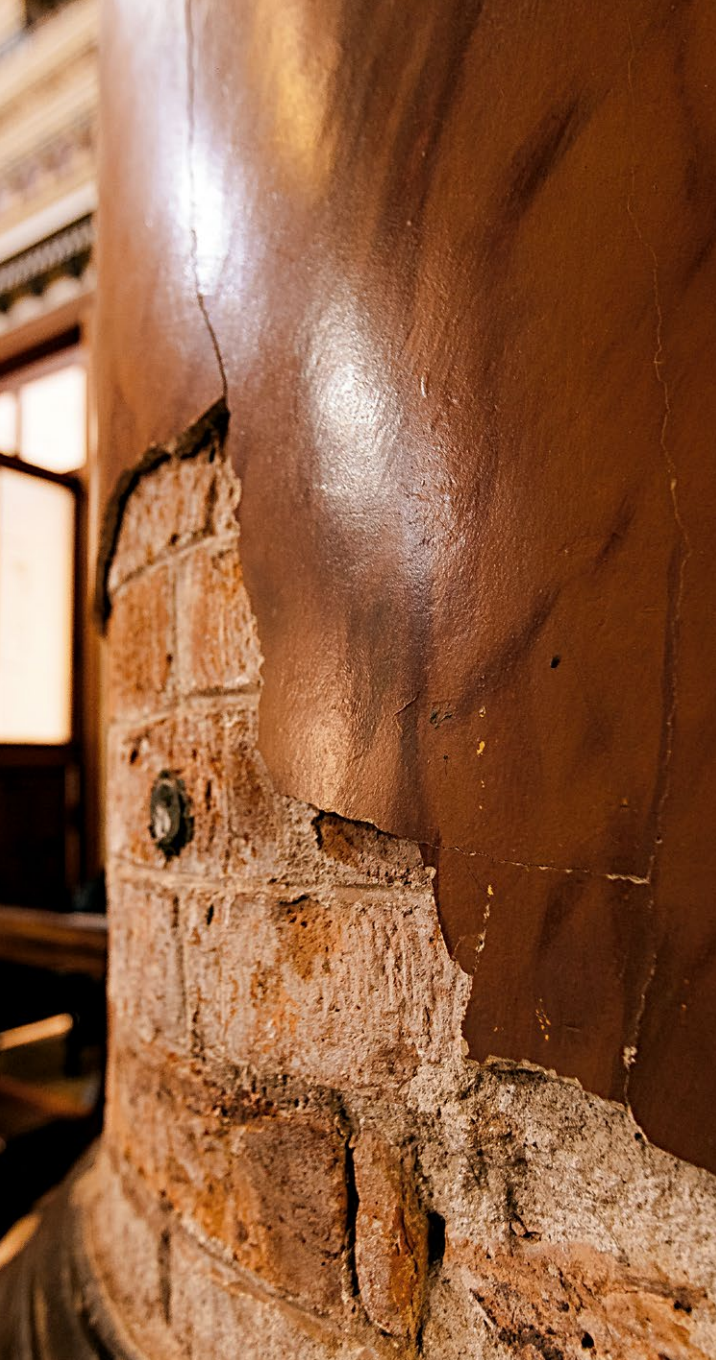
Infiltração e fissuras estão por toda parte
