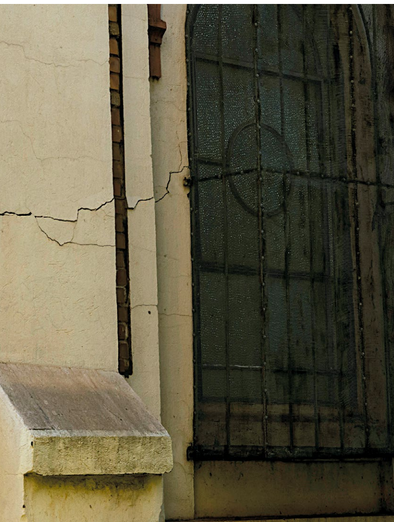
A torre já cedeu 20 centímetros para frente
