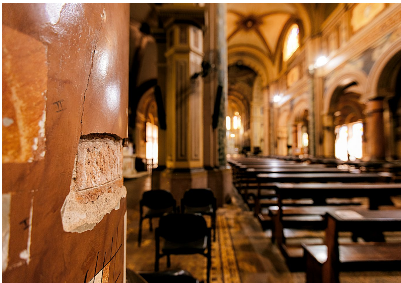
Muitas partes já estão comprometidas
